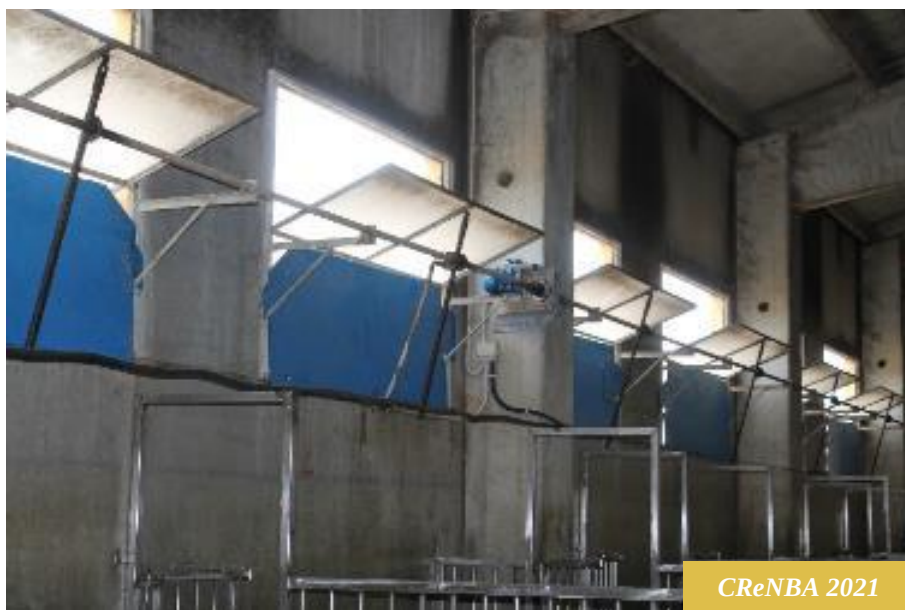
Figura 52 - Condizioni microclimatiche idonee per gli animali: es. ventilazione naturale garantita da finestre ad apertura/chiusura automatica (anche se azionate sulla base della rilevazione delle condizioni ambientali, per essere ottimali dovrebbero essere associate ad impianti di estrazione).
