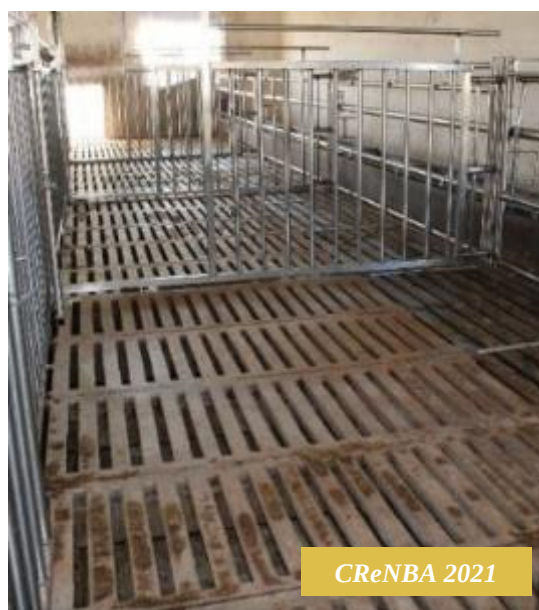
Figura 40 - Fessurato in cemento non rivestito.
